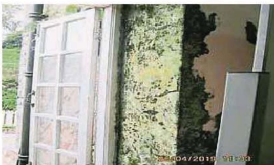
斯里柏卡休閒屋其中一边的墙面，因水管破裂，导致墙漆脱落，还长出青苔。(2019年4月25日摄)
